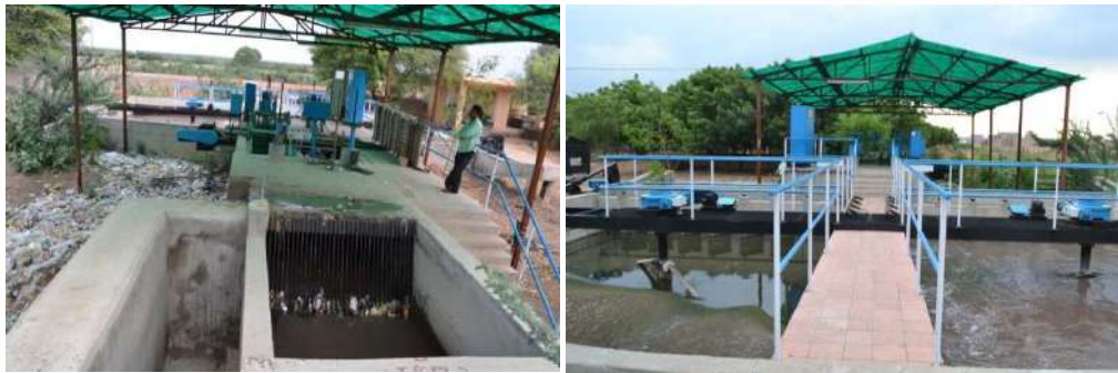
सीवरेज ट्रीटमेंट प्लांट, नान्दड़ी
